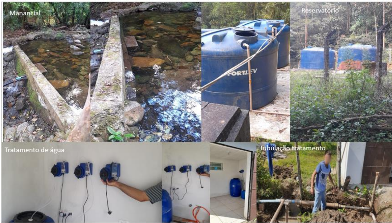
Figura 2. Sistema de captação de água da colônia Maria Luíza. Fonte: Os autores (2023)
