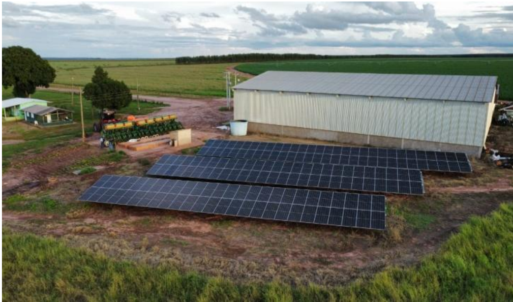
Figura 2. Estação de Energia Solar, Campo Grande – MS. Fonte: autores (2025).
