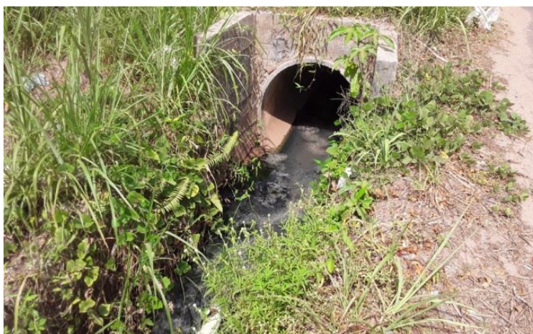
Imagem 04. Registro de uma galeria despejando resíduos no leito do igarapé. Fonte: Autor (2020). Fonte: Autoria própria (2020)
