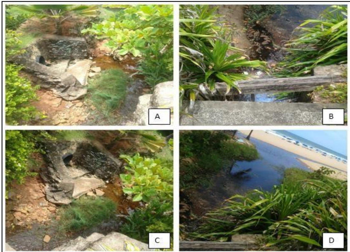
Figura 5. Quadro de fotografias do restaurante defronte ao mar em Stella Mares. Foto A e C: Duto de esgoto a céu aberto. Foto B: Efluente. Foto D: Efluente lançado diretamente sobre ambiente praial. Fonte: Autores, 2021.
