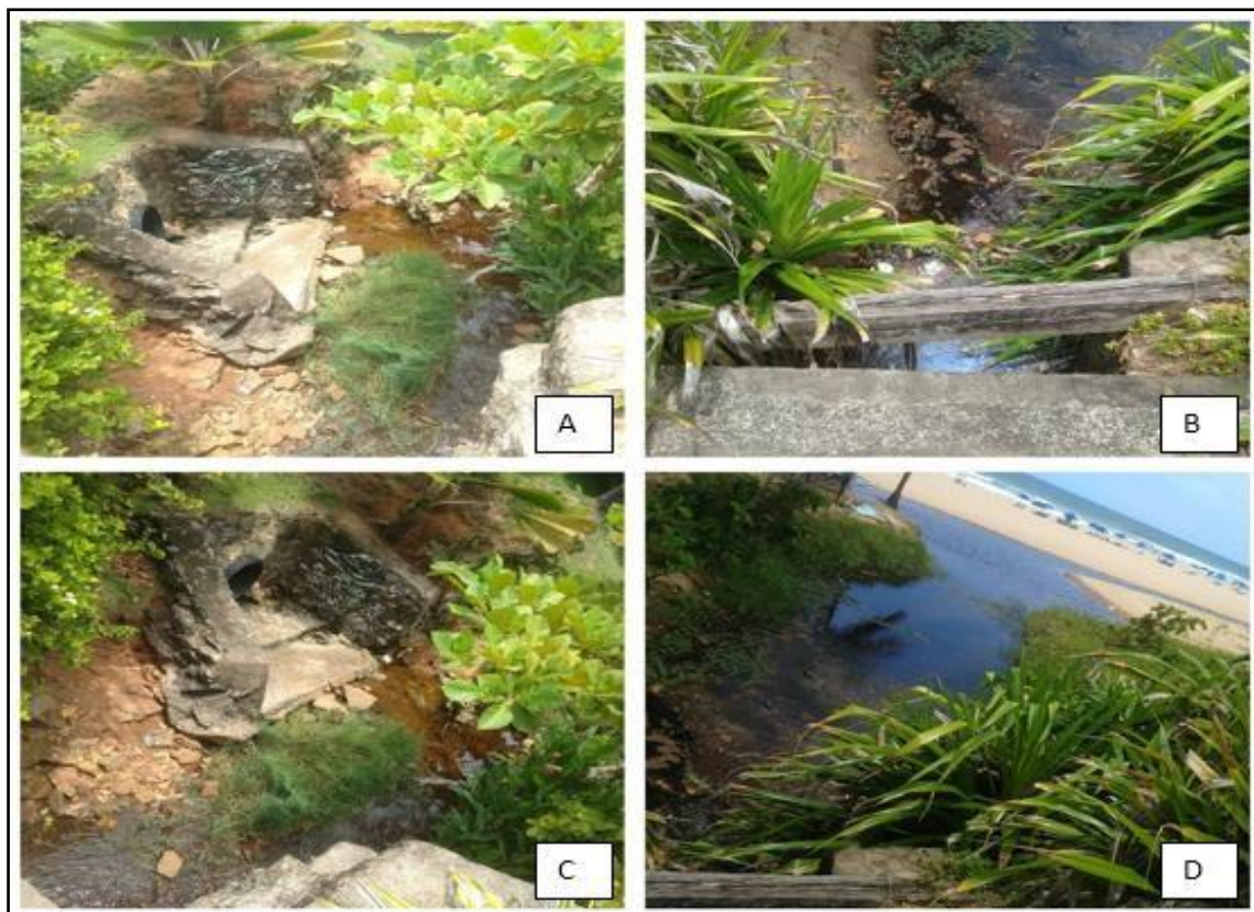
Figura 5. Quadro de fotografias do restaurante defronte ao mar em Stella Mares. Foto A e C: Duto de esgoto a céu aberto. Foto B: Efluente. Foto D: Efluente lançado diretamente sobre ambiente praial. Fonte: Autores, 2021.
