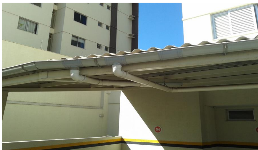
Figura 1. Captação da água no telhado da edificação. Fonte: o(s) autor(es).
