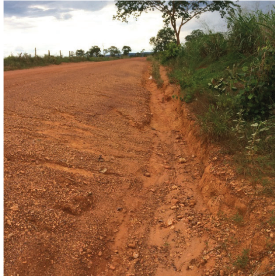
Figura 8. Material granular transportado para fora da pista devido ao sistema inadequado de compactação. Fonte: Autores.
