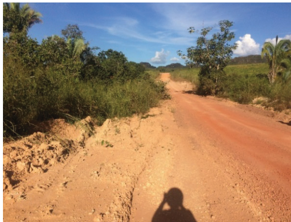
Figura 9. Falta de roçado em dispositivo de drenagem. Fonte: Autores.
