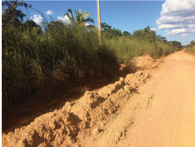
Figura 6. Sistema de drenagem presente na MT-448. Fonte: Autores.
