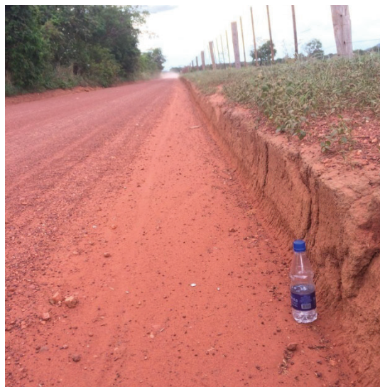
Figura 7. Afundamento do greide provocado pelas patrolagens sucessivas realizadas de forma incorreta. Fonte: Autores.
