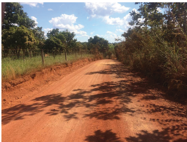
Figura 4. Trecho da via com falta de um sistema de drenagem. Fonte: Autores.
